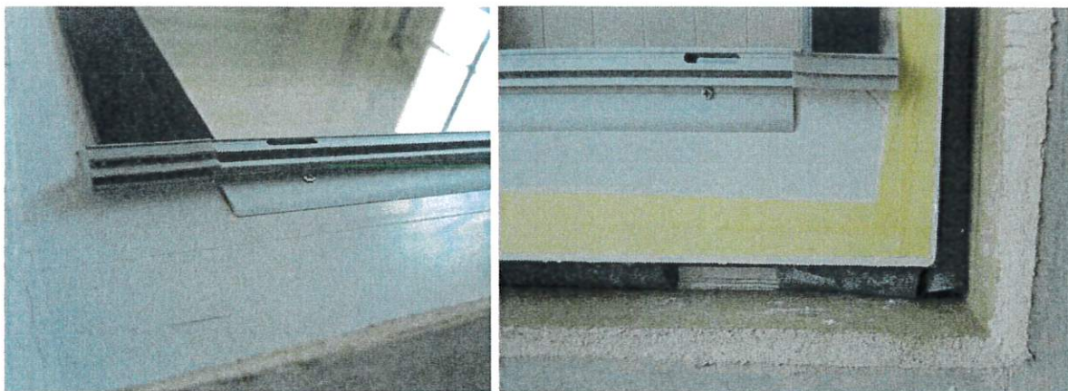
Abb.2: kein Gewerke Loch aufgrund Verwendung von Rahmenverbreiterung (links) die Fuge war umlaufend mit 2 Stück. Rundschnüren gefüllt (rechts)
